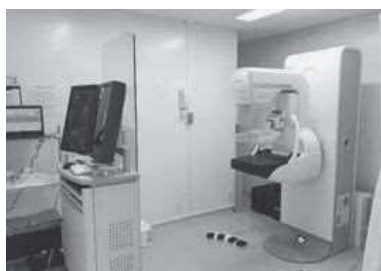
放射線検査室に設置された マンモグラフィ撮影装置
